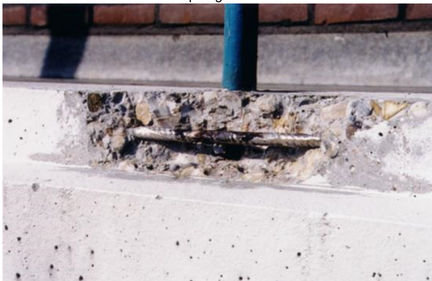
Constructieve schade in een betonnen ondergrond.
