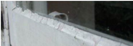
Stopverf met asbest valt in risicoklasse 2
